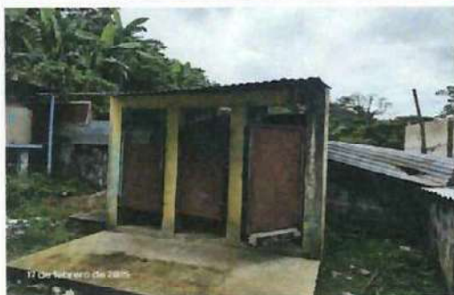
Foto 3: Se observa deterioro en la estructura de la letrina
