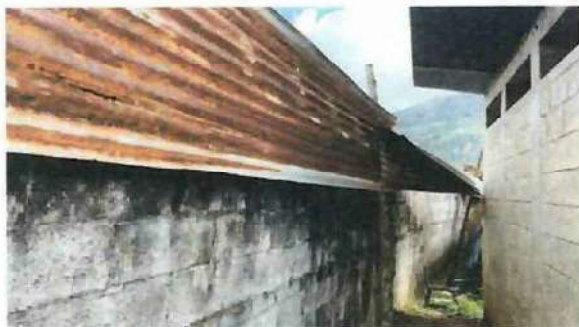
Foto 1: Se observa deterioro en el muro perimetral de los módulos.
