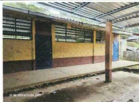
Foto 4: Se observa deterioro en la pintura del modulo No. 1.
