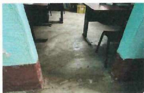
Foto 5: Se observa deterioro en el piso.
